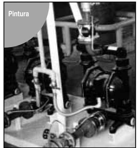
Bombas ARO PD20X-A usadas en la fabricación de barnices.
